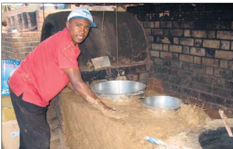
Energiesparende Herde wie dieser, die sich mit geringem Aufwand bauen lassen, sollen bei möglichst vielen madagassischen Familien Einzug halten. Fotos: e
